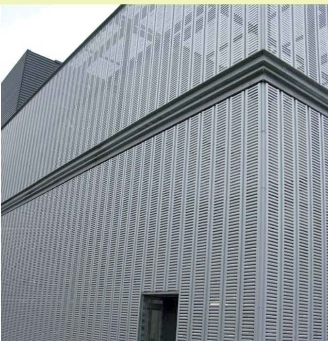
↑ Le bâtiment de commande et les deux transformateurs sont habillés de lames perforées, sans isolation.
